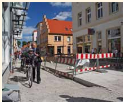
Stolperfallen und graue Tristesse kennzeichneten den Boulevard Schuhhagen vor der Sanierung.
